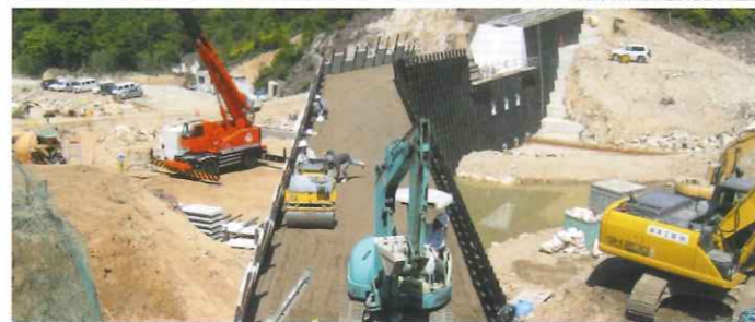
ソイルセメント工法で、施工された砂防。セメントの水和反応を活性化することで、その圧縮強度は2,000kN/m 2 を超える。
